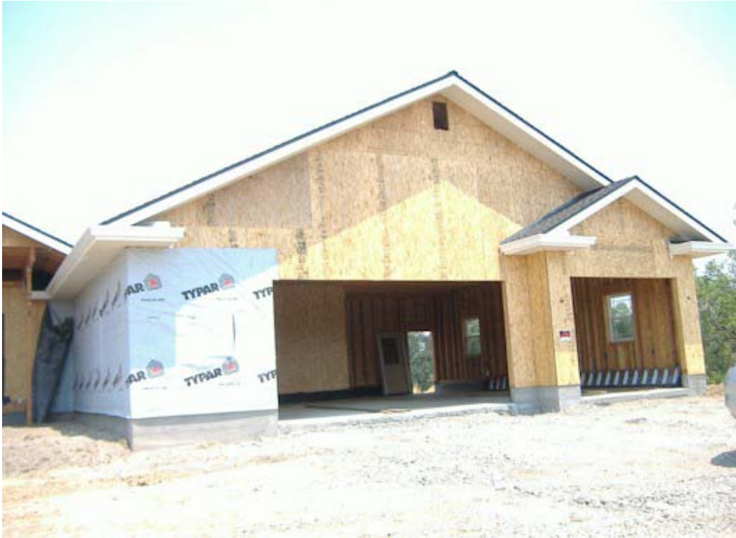
大きなガレージ部分の写真でスラブ基礎がよくわかります
