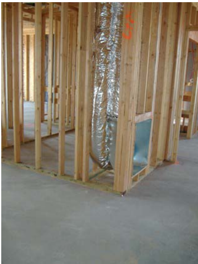
これはスラブ床(基礎)の上に内壁を建てている現場です
